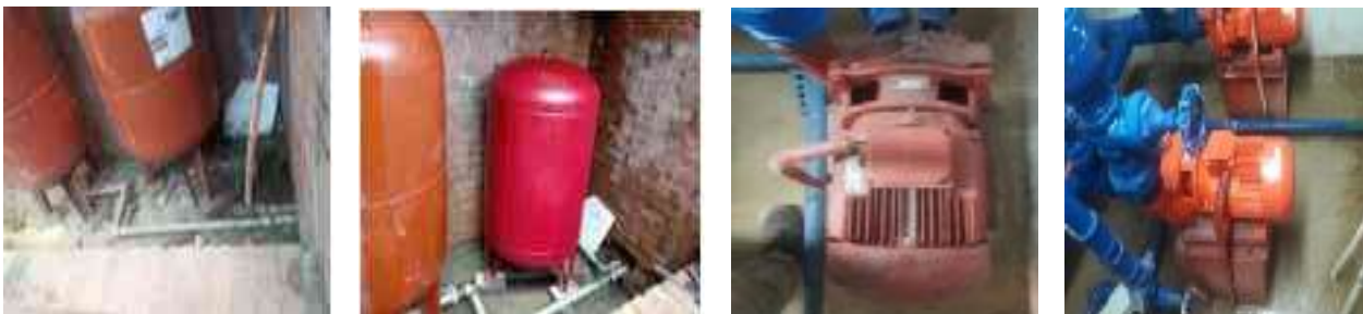
Fotografía 54. Electrobombas Hospital Local del Norte
