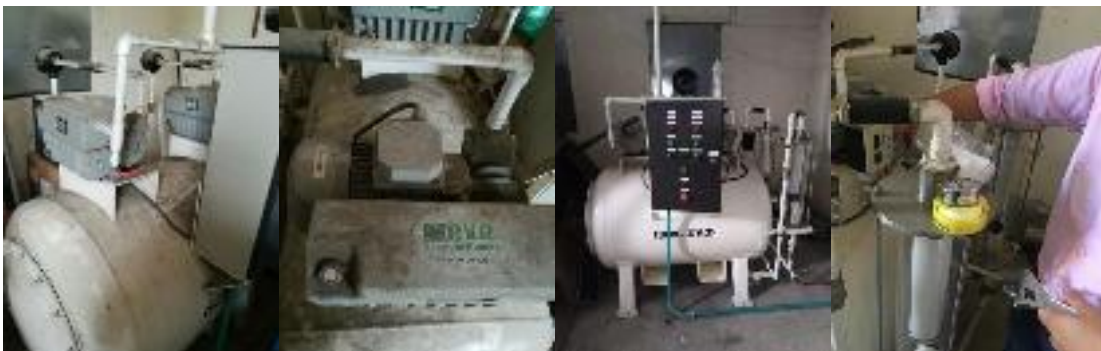
Fotografía 48. Bomba de vacio
