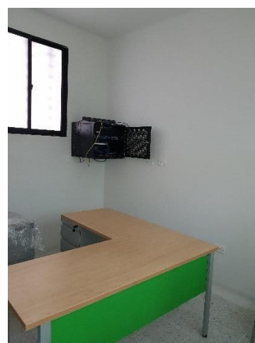
RACK INSTALADO EN AREA DE FACTURACION.
