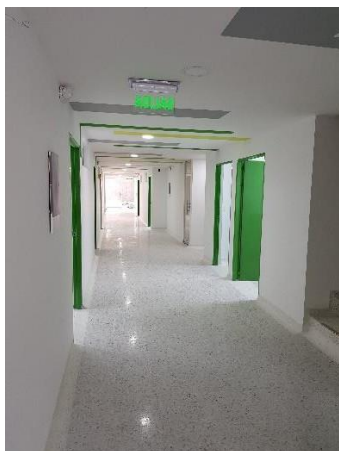
PASILLO DEL PRIMER PISO, PINTURA EN MUROS
