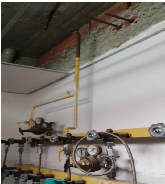
Salida de red de central de gases hacia pasillo
